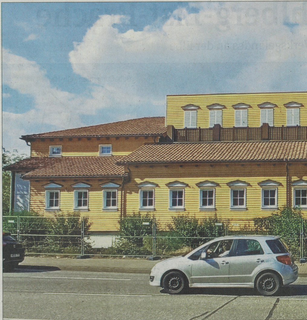
Blick auf das neue mexikanische Restaurant „Espitas“. Noch laufen die Bauarbeiten an der Albert-Vater-Straße. Der Termin steht inzwischen auch schon fest.
